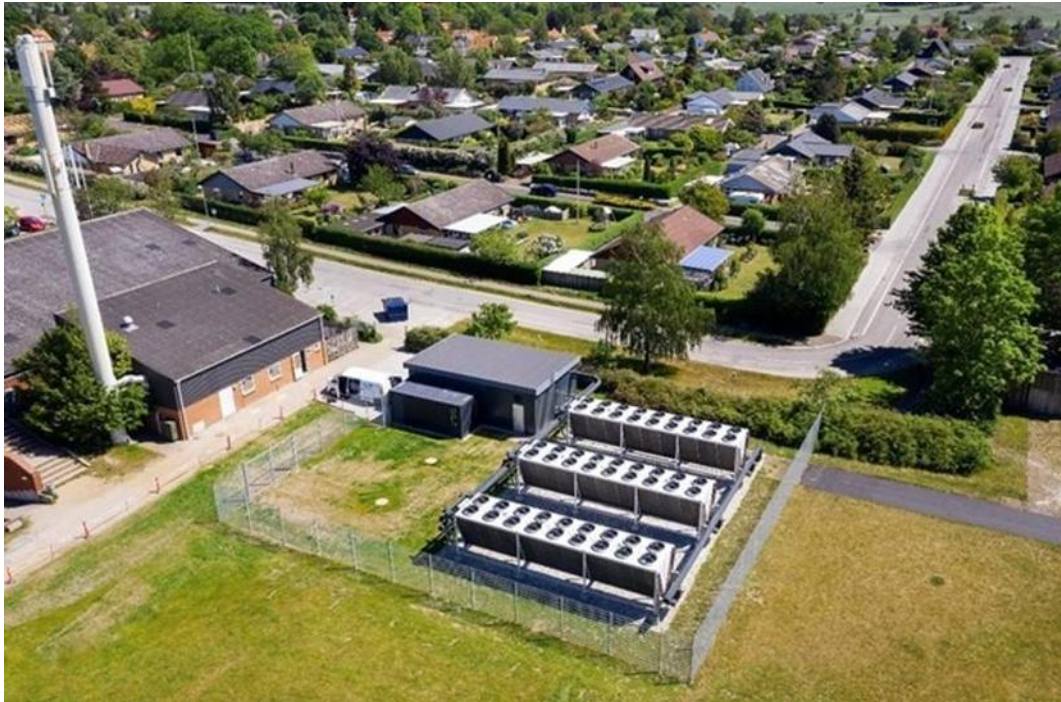
Abbildung 3-12: 1,2 MW Luft-Wärmepumpe in Slagslund Dänemark (Quelle: PlanEnergi)
