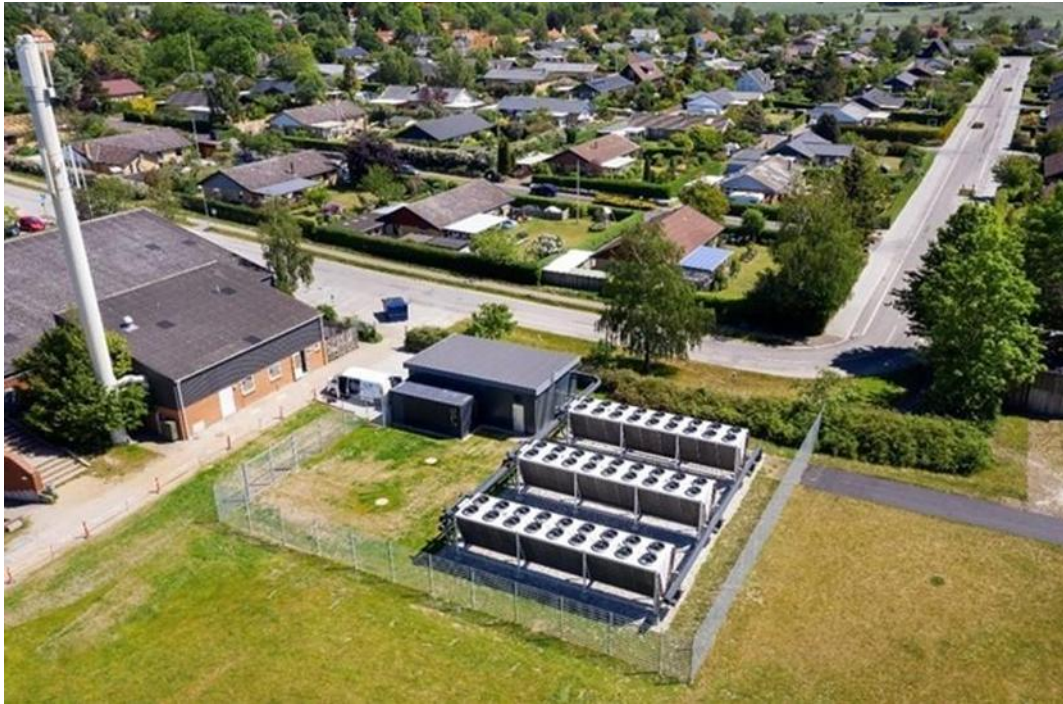
Abbildung 3-15: 1,2 MW Luft-Wärmepumpe in Slagslund Dänemark (Quelle: PlanEnergi)
