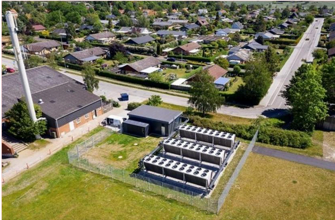
Abbildung 22: 1,2 MW Luft-Wärmepumpe in Slagslund Dänemark (Quelle: PlanEnergi)
