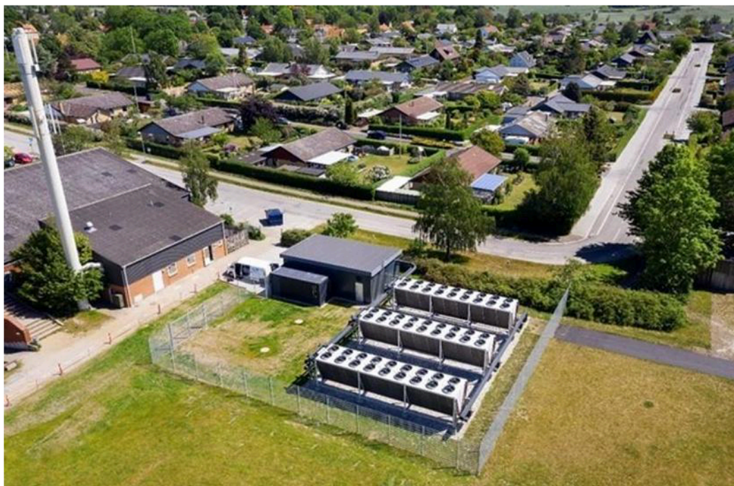
Abbildung 22: 1,2 MW Luft-Wärmepumpe in Slagslund Dänemark (Quelle: PlanEnergi)
